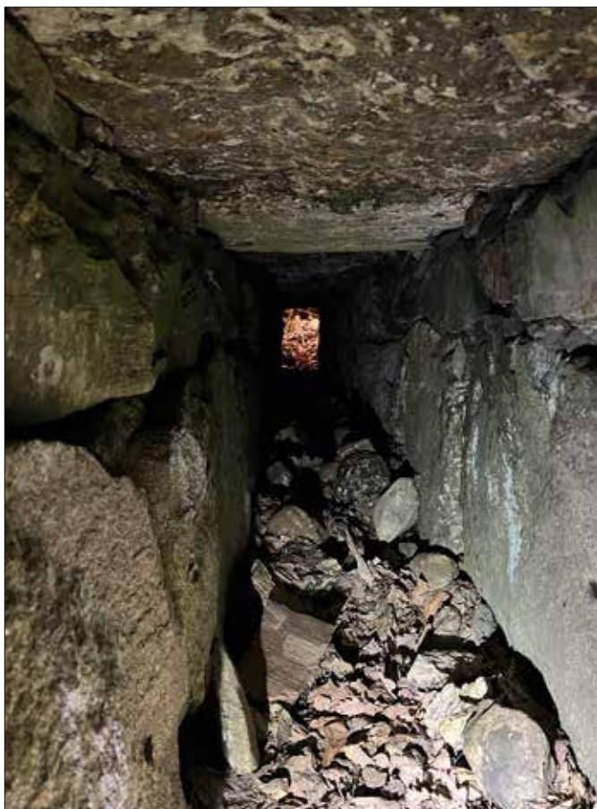
Samme stikkrenne, motsatt ende (Foto: Afk).
