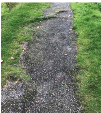
Over: Gangvei. Asfaltdekke med dårlig standard.
